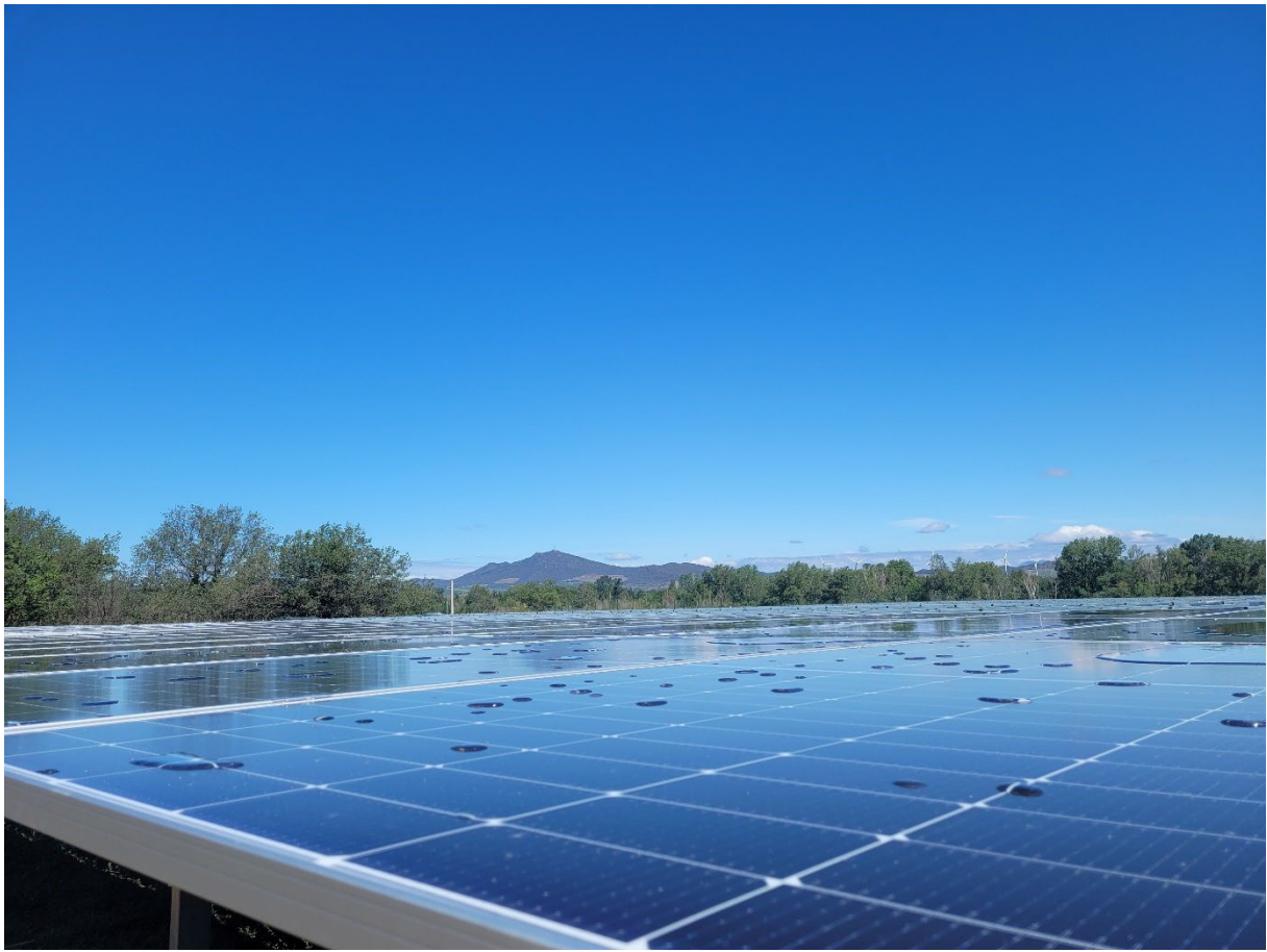
Photos publiables du projet photovoltaïque SAINT FELIU D'AVALL, © ELEMENTS
